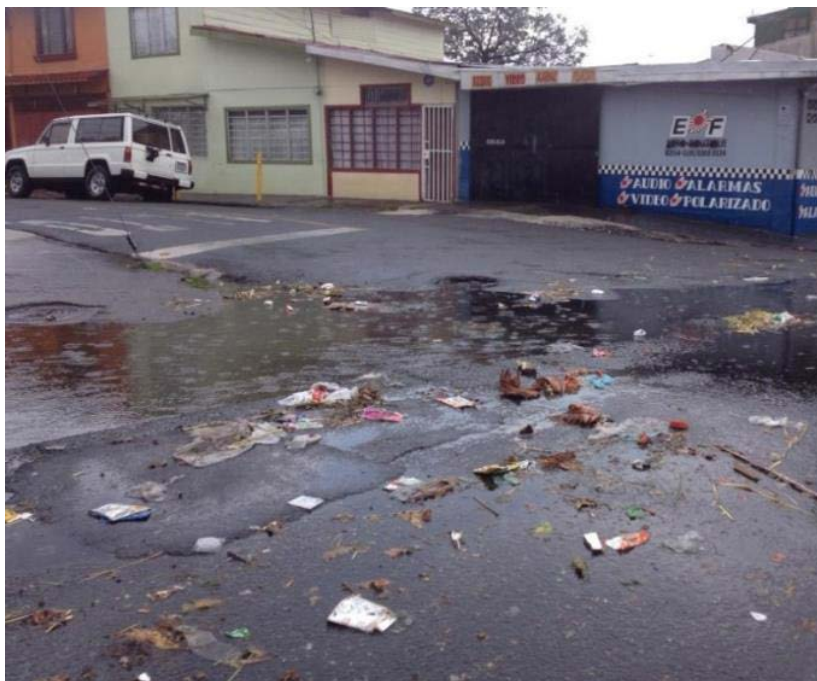
Suelo sellado completamente que no deja infiltrar el agua de lluvia causando inundaciones.
